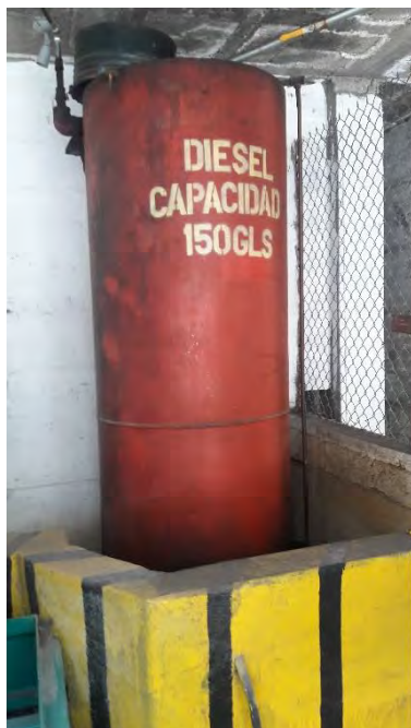
Fotografía 3: Almacenamiento de Diesel para el Generador CUMMINS
