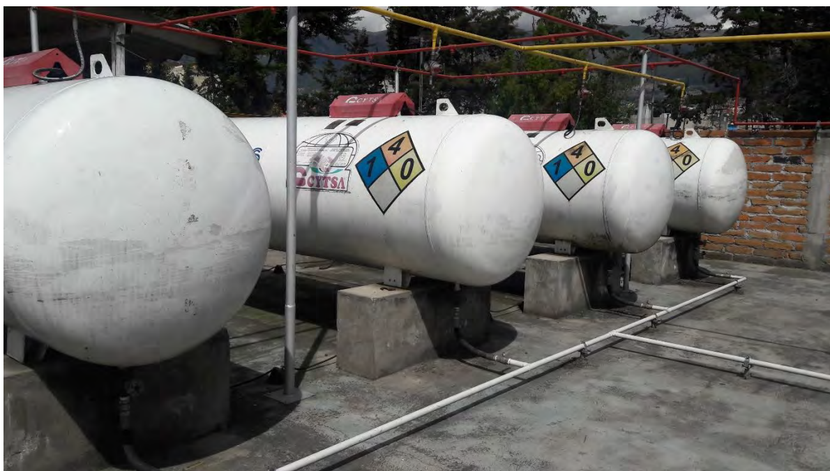
Fotografía 2: Sistema Centralizado de GLP
